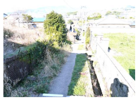
⑫ 溝蓋のない側溝があり注意
